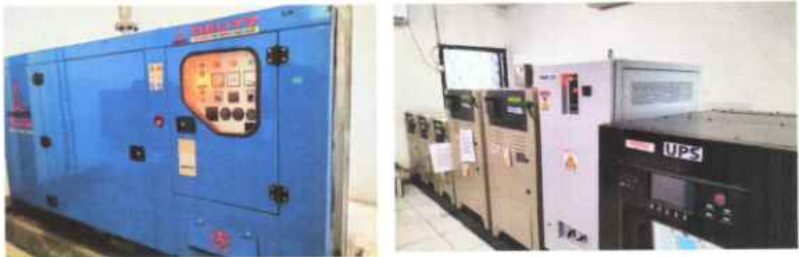
GENSET 50 KVA & 100 KVA
