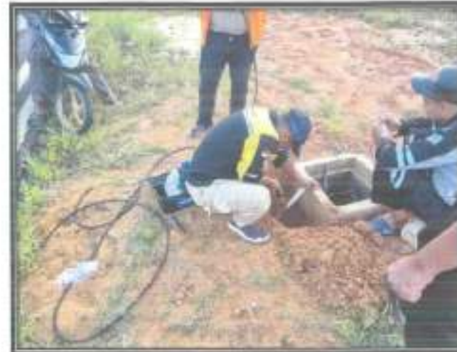
Instalasi lampu inlet
