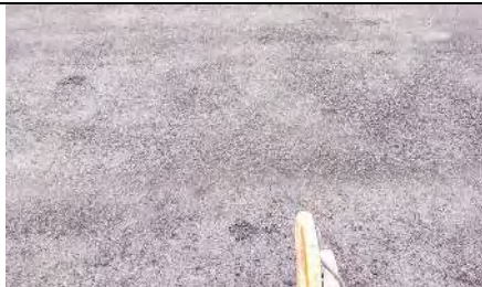
Terdapat Potholes pada runway
