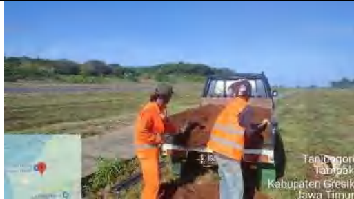
Tapping tanah padat beda tinggi penutup drainase dan shoulder sisi selatan runway
