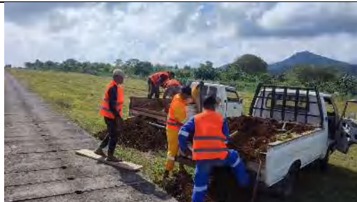
Tapping tanah padat beda tinggi penutup drainase dan shoulder sisi selatan runway
