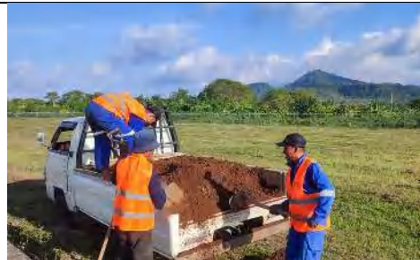
Tapping tanah padat beda tinggi penutup drainase dan shoulder sisi selatan runway
