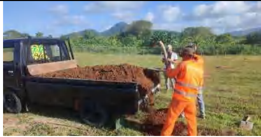
Tapping tanah padat beda tinggi penutup drainase dan shoulder sisi selatan runway
